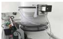
3 Ablufthaube mit Stellglied, Messeinrichtung und Messwerterfassung
